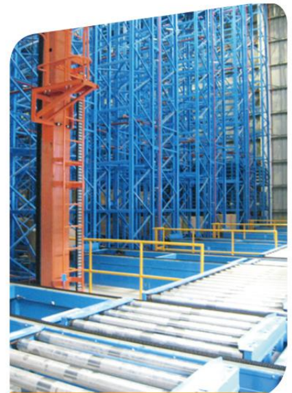
水平输送及接驳系统 Horizontal Conveying and Feeder System
